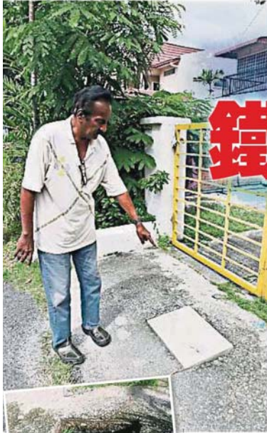
↑一早前被偷窃的沟渠铁盖，所留下的洞口已获填补。
