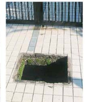
↑SS15/2、3路共有12个沟渠铁盖被偷，居民被迫花贵填补洞口。
